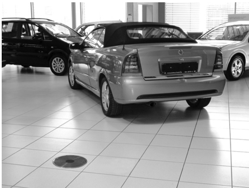
➤ Obrázek 4: Elektroinstalační rozvod v podlaze autosalónu
